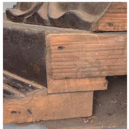
[図37]反花と框の(背面) 鉄釘の錆
