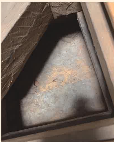
〔図58〕框(内部) 生物(鼠か)巣除去後
