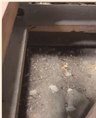
〔図57〕框(内部) 生物(鼠か)巣除去前
