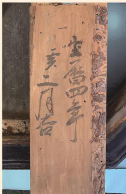
[図197]構造材上部の修理銘
